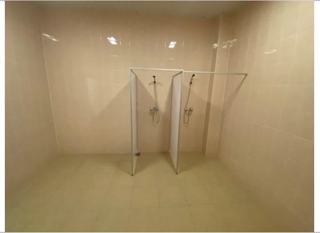
Фото №56 – Санитарно-гигиеническое помещение (душ)
