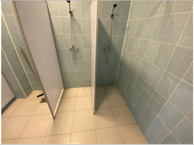
Фото №55 – Санитарно-гигиеническое помещение (душ)
