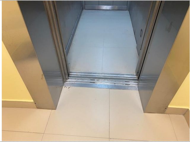
Фото №25 – Пути движения внутри здания (лифт)
