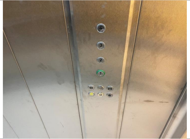
Фото №26 – Пути движения внутри здания (лифт)
